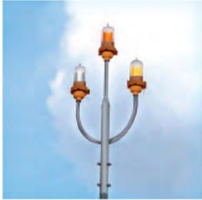
ไฟแจ้งเตือนปิดการทำงาน
